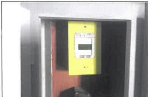
Photo du Compteur électrique
